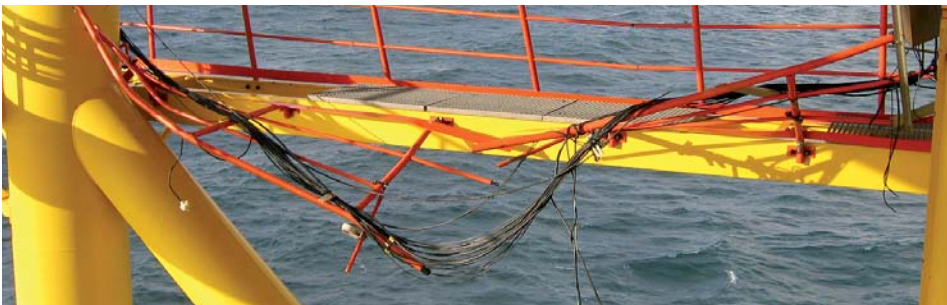
Seegangsschäden nach dem Orkan Britta an der Messplattform FINO in 15 m Höhe über dem Meeresspiegel
