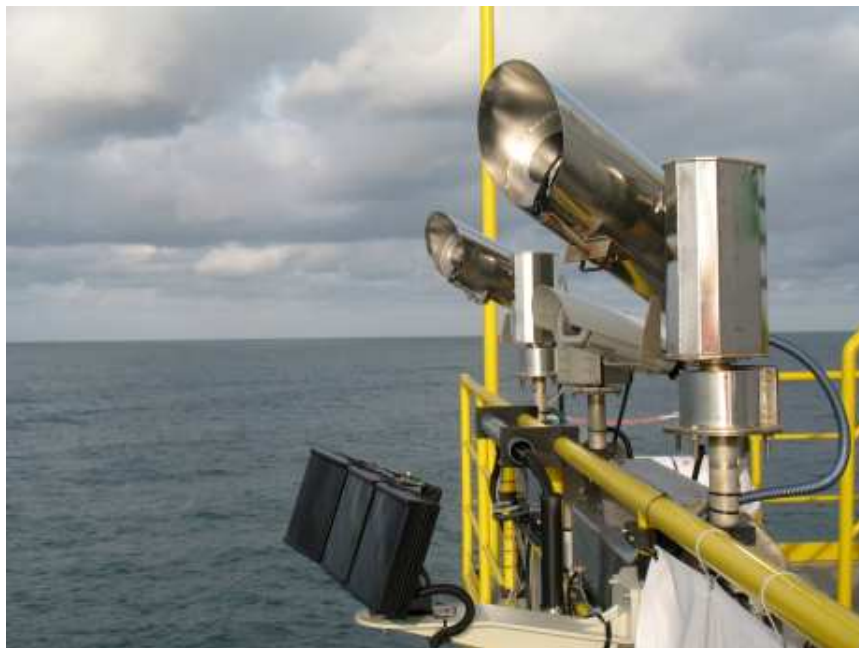
Abbildung 5.1: Die Videokamera in der Mitte zwischen den beiden Wärmebildkameras auf dem Umspannwerk von alpha ventus
